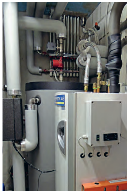
Ein Blick in den Heizungsraum des Hauses Gstell Nr. 748 in Lutzenberg: Mit der Steuereinheit (im Vordergrund) wird die Übertragung von Erdwärme in Heizwärme im Wärmetauscher (im Hintergrund) geregelt.
